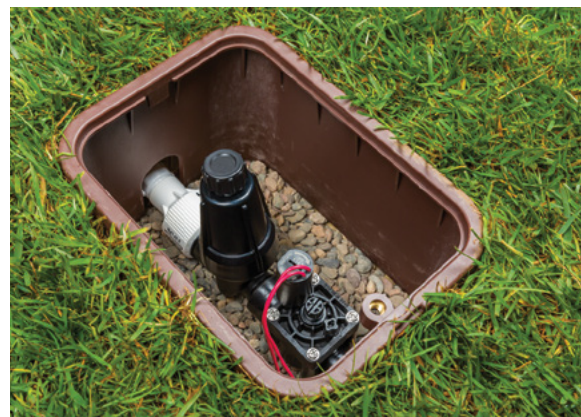
Пример установки PCZ-101 в универсальном корпусе
